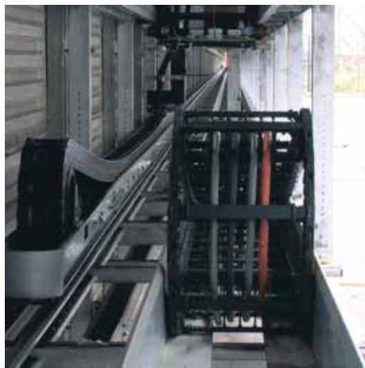
Versuchsanlage für lange Verfahrswege: Geschwindigkeit 8 m/s; Verfahrsweg 130 m
